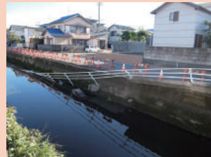
西島／中田1号雨水幹線 パイプガード破損
