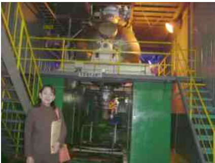
<汚泥処理実験施設(留萌)> 肥料以外の再利用が注目!
